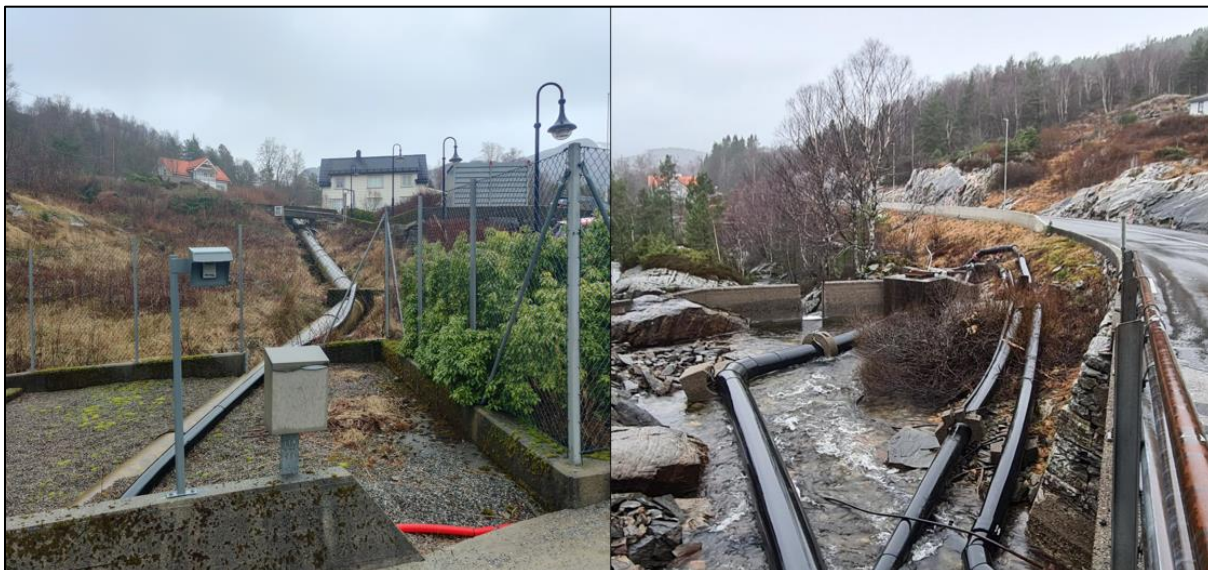
Figur 10: Foto av røyrgate som gjev vasstilførsel frå Sørkvingevatnet til anlegget. Til venstre: røyrgate som ligg innafor planområdet. Til høgre: deler av røyrgata som ligg utanfor planområdet, ved bru fylkesvegen.
